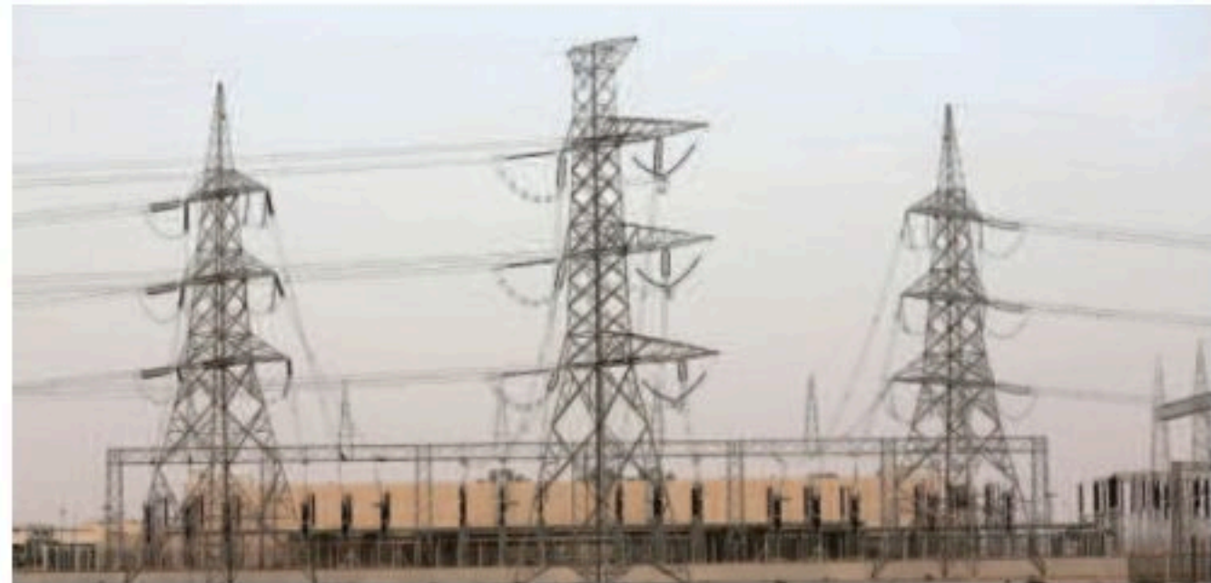
محطة سدير لتحويل الكهرباء
